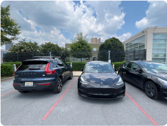
Conduit Run to Charger
